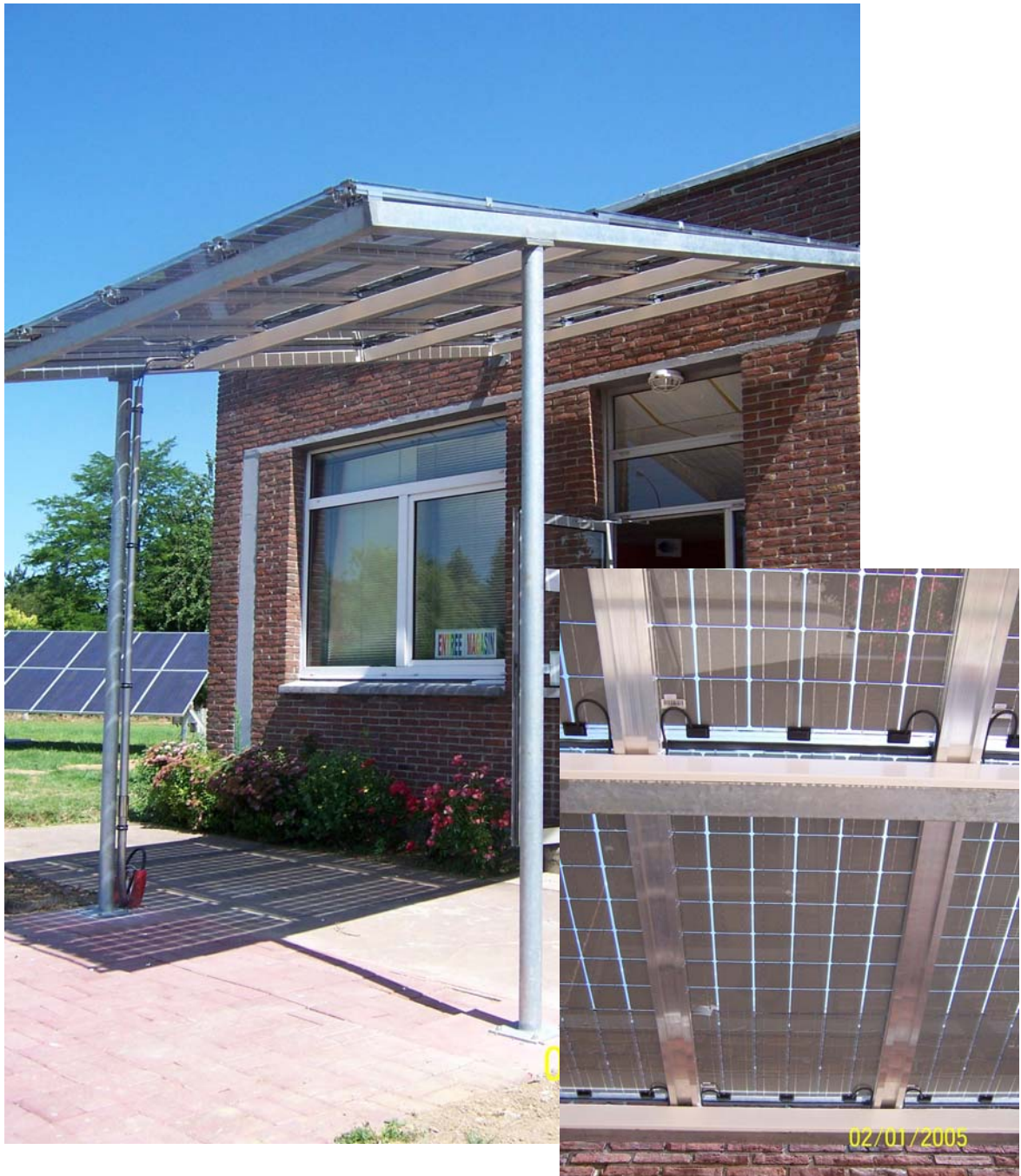
solares Vordach, 1,4 kWp Dachintegration mit Solardach III auf Stahlpfetten Henin, Frankreich
